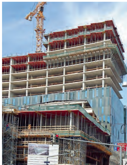
Beim gleichzeitigen Arbeiten verschiedener Gewerke ist richtige und zeitgerechte Koordination der Schutzmaßnahmen unerlässlich.
