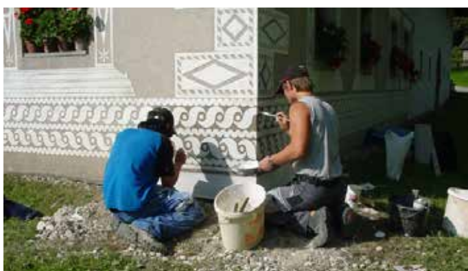
Freilichtmuseum Stübing: Die Lehrlinge der BAUAkademie Steiermark unterstützten tatkräftig bei der Sanierung der alten Bauwerke.
