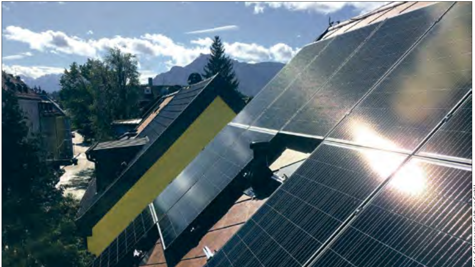
Foto: Solarenergy Salzburg GmbH
