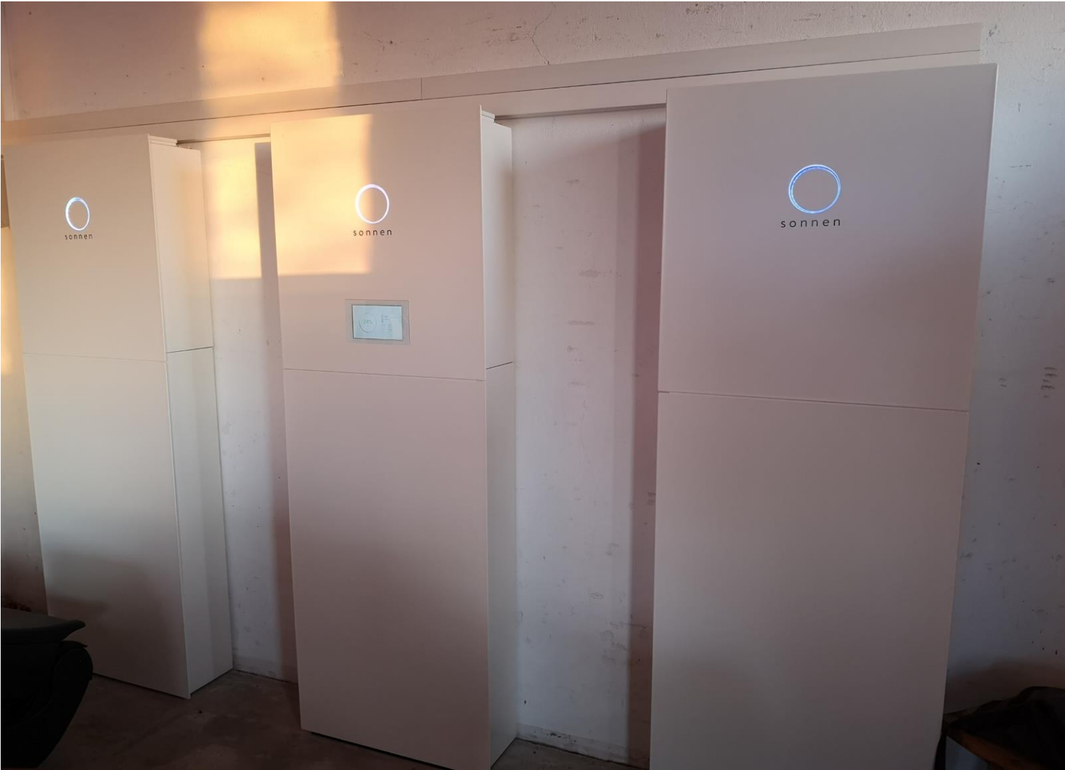
Baustein Ökstrom speichern: stationärer Energiespeicher mit 30 kWh
