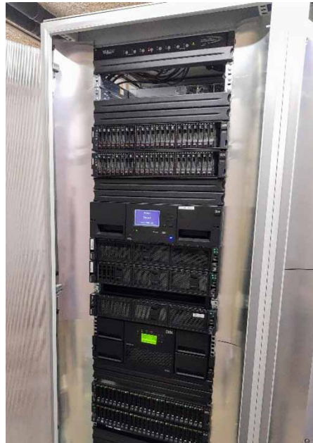
Serverrack mit Blindblenden, Seitenverblendung und Stegplatte zur Luftführung
