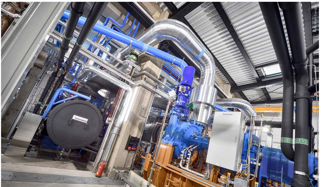
Eine der Großwärmepumpen, die seit 2019 in Simmering klimaneutrale Fernwärme erzeugt.
